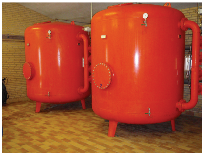
Figur 2. Filteranlæg på Vinderød Skov Vandværk
