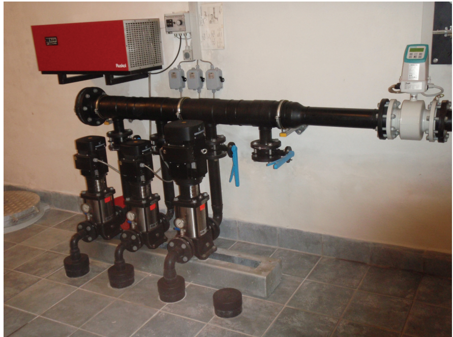
Figur 3. Udpumpningsanlæg på Ølsted Strands Vandværk
